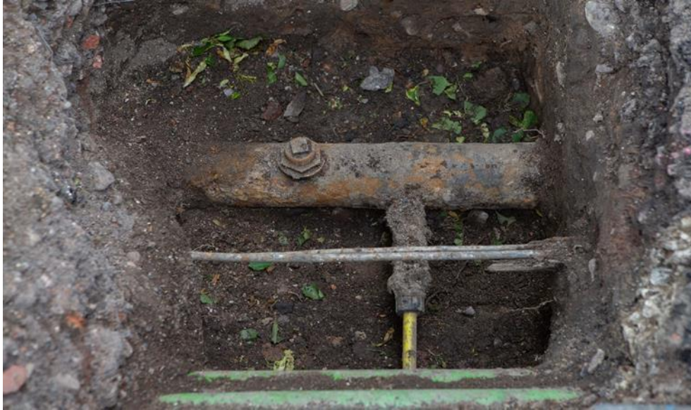
Steel and PE mains
